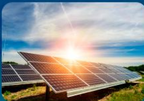
ECONOMIA DE ENERGIA PARA O CONDOMÍNIO ATRAVÉS DE ENERGIA SOLAR FOTOVOLTAICA**
