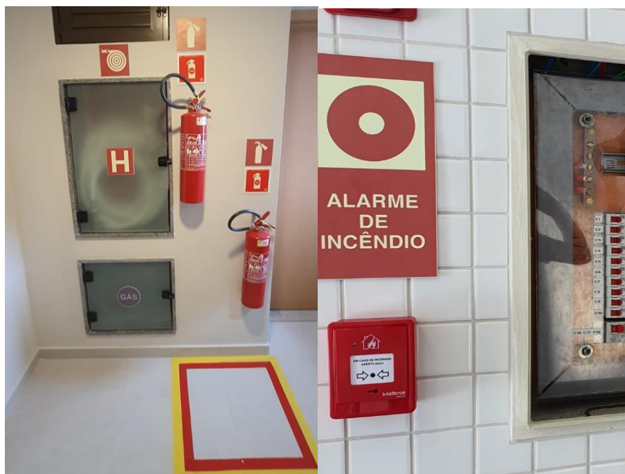
Figura 50 - Sistema de combate a princípio de incêndio (extintores e alarme de incêndio)
