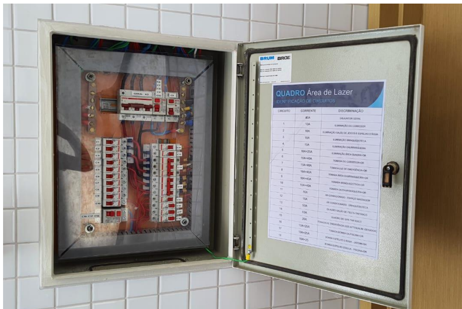
Figura 30 - Quadro de distribuição de energia
