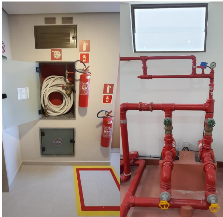
Figura 48 - Sistema de combate a incêndio (hidrante e bombas de incêndio)
