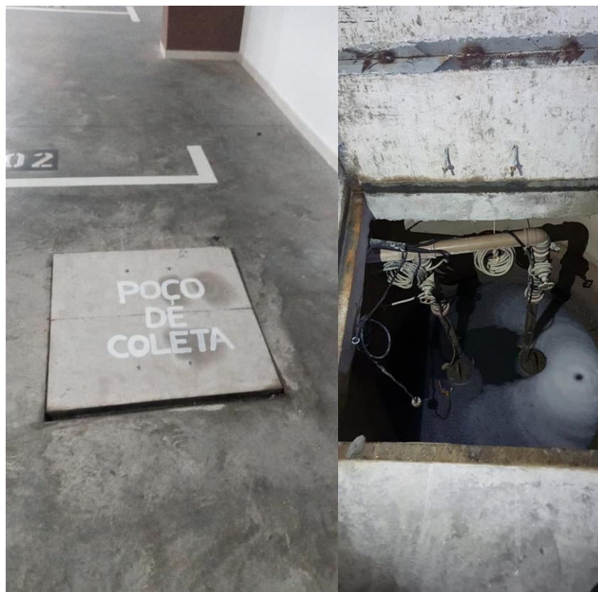
Figura 35 - Poço de coleta com bombas submersas
