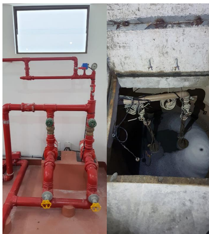
Figura 20 - Bombas de incêndio e bombas submersas
