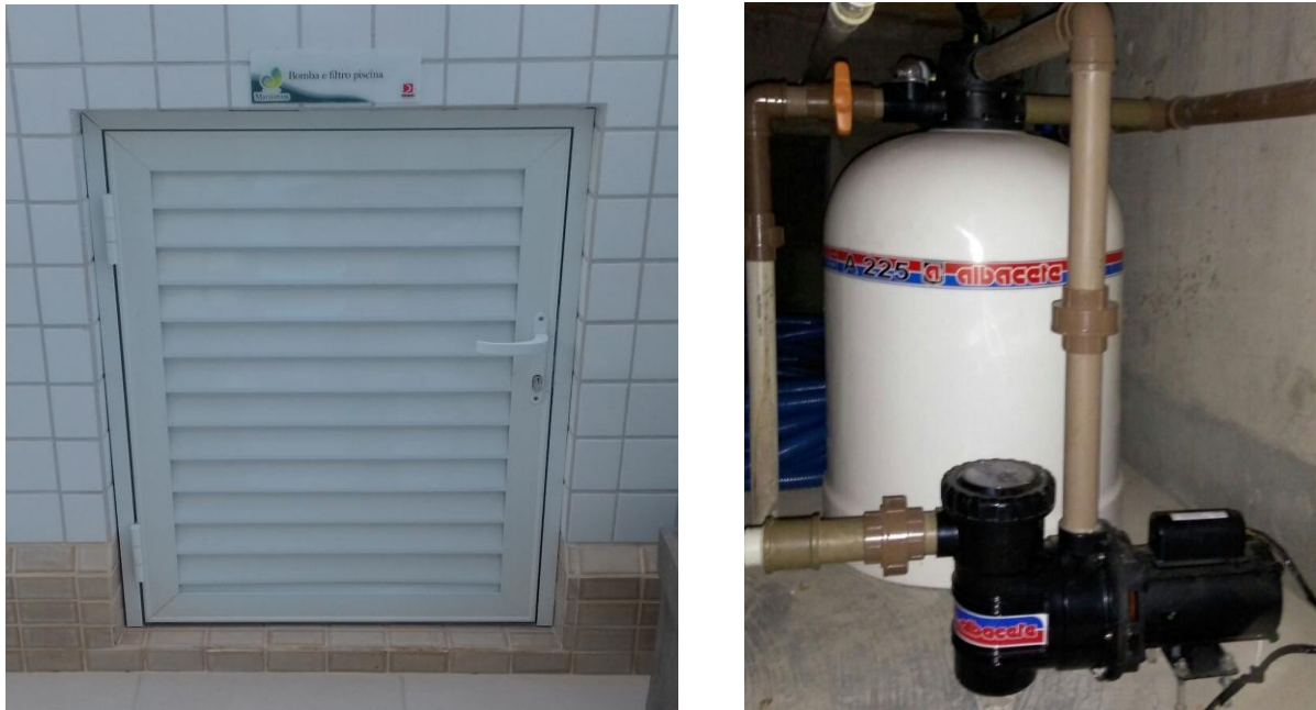
Foto 15 - Filtro da piscina. Observar alavanca principal de controle da função e registros de encher a piscina e de esvaziar. Sempre que a pressão atingir a área vermelha no manômetro é hora de trocar a areia do filtro. Antes de usar, ler com atenção as instruções indicadas no motor.
