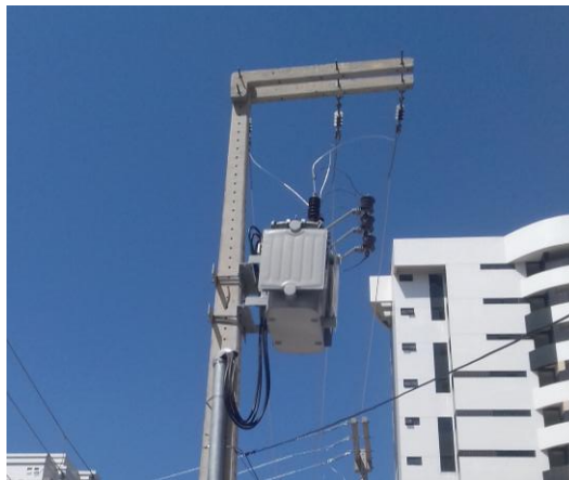
Foto 4 – Subestação aérea. Detalhe do transformador pára-raios de Alta tensão, que estão instalados na calçada do prédio. Manutenção exclusiva da CEMAR.
