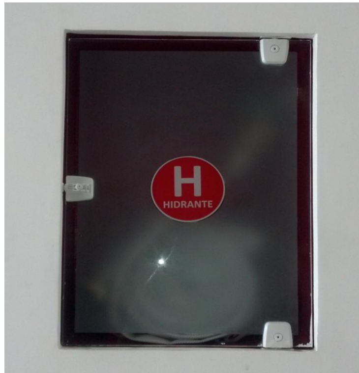
Foto 10 - Caixa de hidrante localizada no hall de serviços de todos os andares, mezanino e garagens
