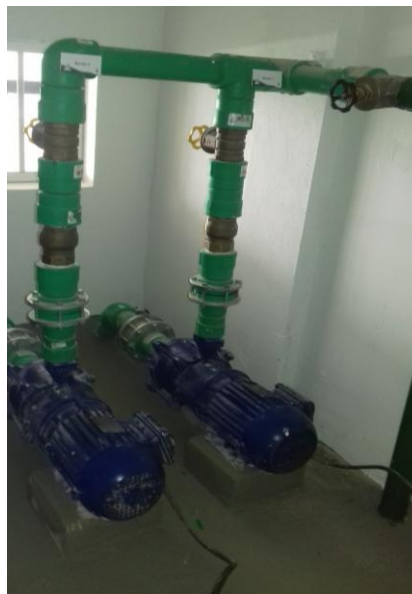
Foto 7 – Bombas de recalque. Observar o registro de bypass (limpeza da cisterna) e o de alimentação da sucção (manutenção). Em condições normais os dois devem permanecer
