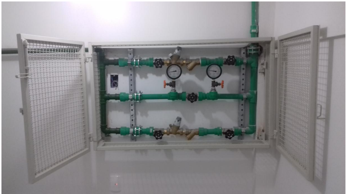
Foto 8 – Válvula redutora de pressão instalada na parede do mezanino na caixa da escada.
