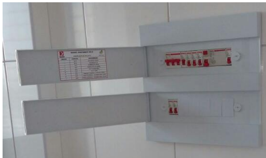
Foto 1 – Quadro de força e iluminação
