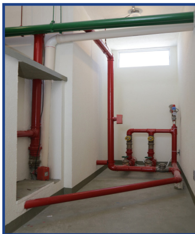
Bombas de incêndio
