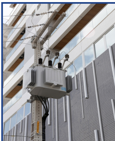
Subestação de energia
