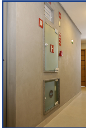
Caixa de gás
