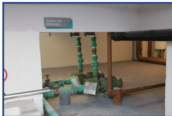
Bomba de recalque
