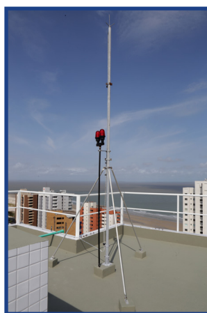
Equipamento de SPDA
